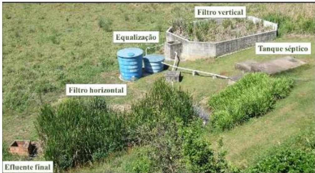
Figura 10 - Estação de tratamento de efluentes CETREVI. Fonte: Favretto (2017)
